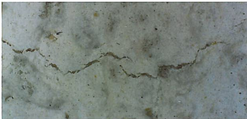
Kuva 3.5. Koeseinässä esiintynyttä halkeilua.
